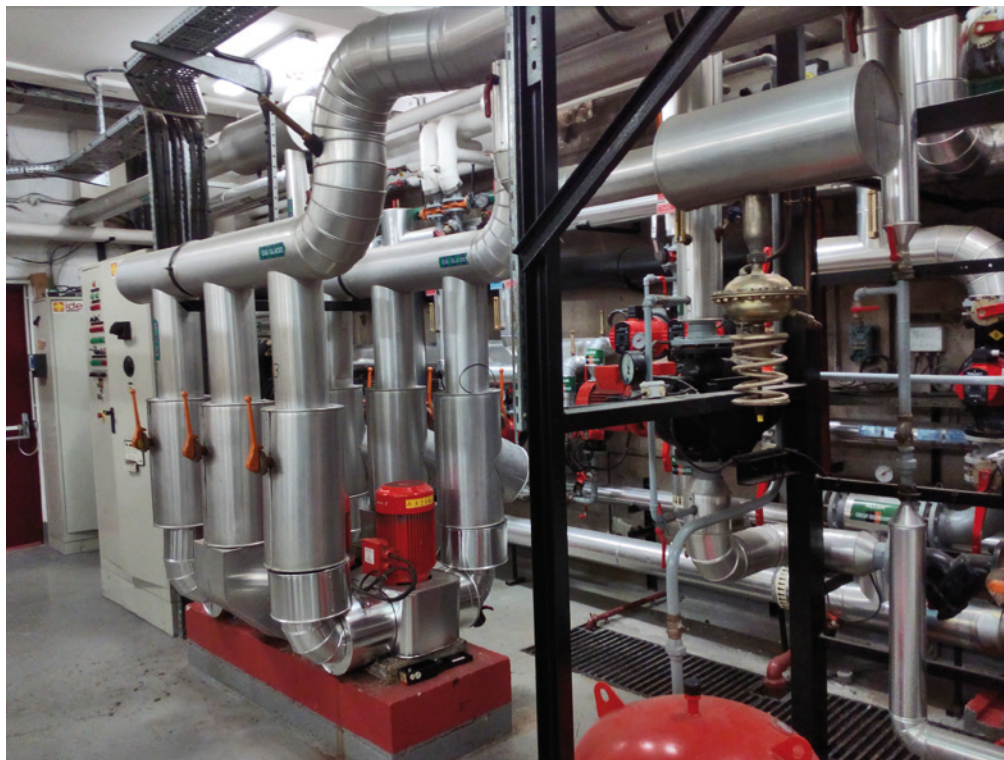
■ Bienvenue à la chaufferie dans les sous-sols de la mairie, une ville dans la ville. Trois circuits transitent par ce vaste local impeccablement tenu : eau chaude, sanitaires, refroidissement pour la climatisation en été. Le ballet est réglé par ordinateur avec débrayage possible pour l'intervention humaine.
