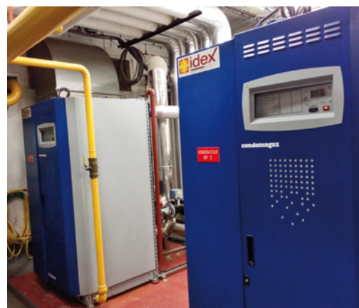
■ Les chaudières atmosphériques ont été remplacées par deux chaudières à condensation, ultramodernes et beaucoup plus performantes.
