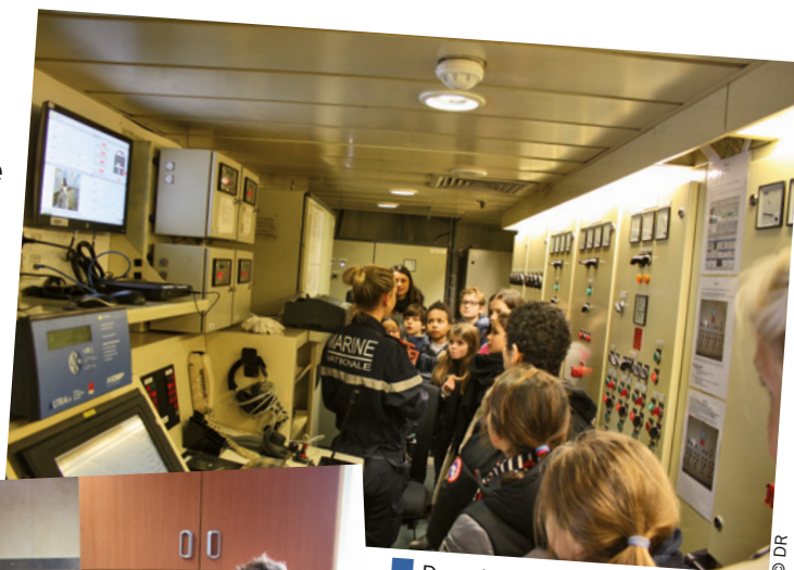
■ Dans la salle des machines.
