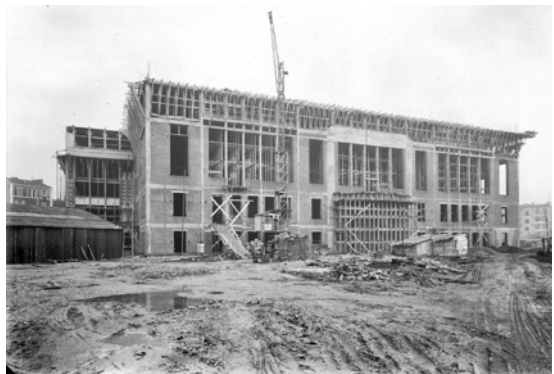
■ Façade principale de l'hôtel de ville en cours de construction, vers 1933. Le vide créé par les structures en béton a été comblé de briques et déjà s'esquissent les hautes baies de l'étage noble.
