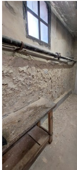
Mur latéral dégradé
